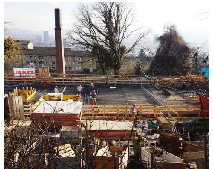
Noch ist die Wärmezentrale Käferberg eine Baustelle. Ab 2018 wird hier mit Holzschnitzeln aus regionalen Wäldern Energie produziert.
