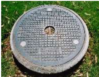
Verschliessbarer, dichter Deckel Beschriftung: «Schlammsammler Versickerung»
