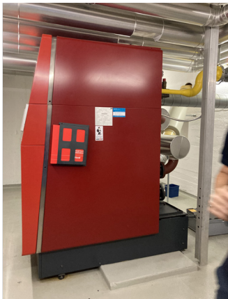
Gasheizung im Schulhaus
